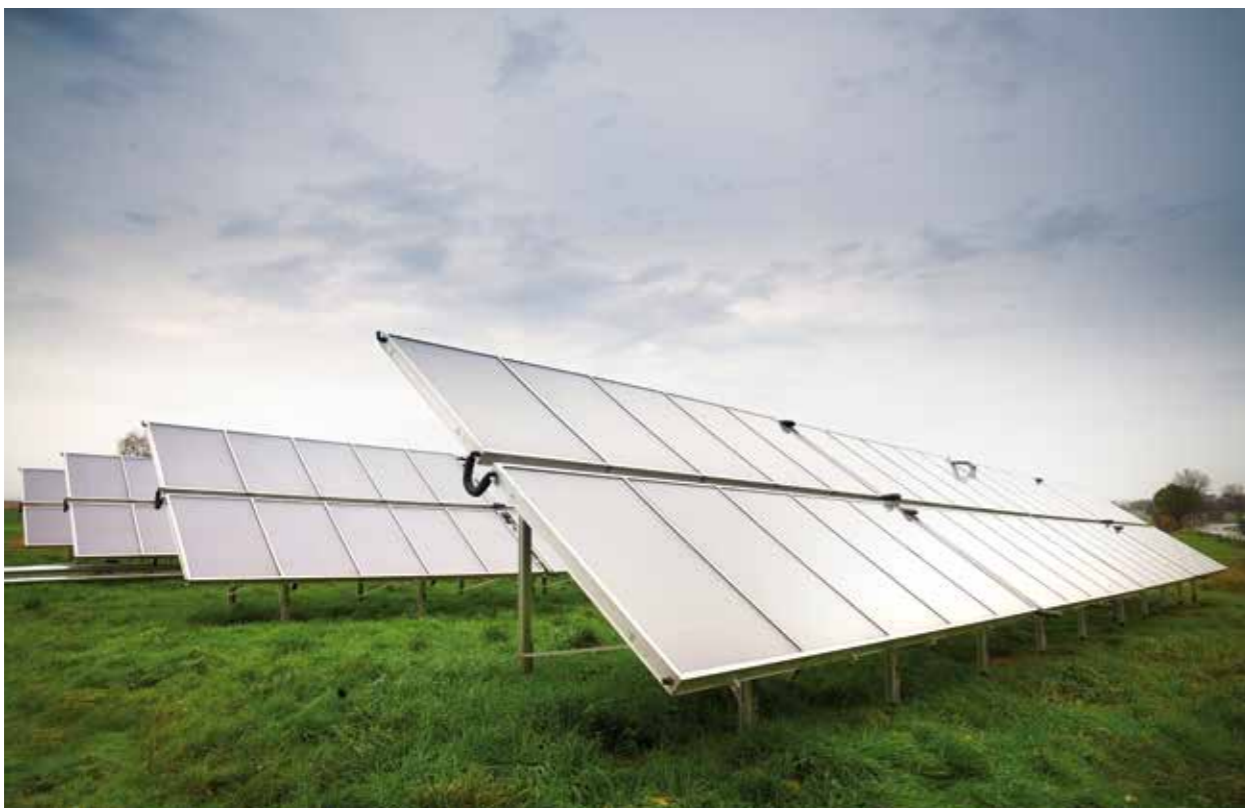
Solarthermische Beheizung von Gasdruckregelanlagen (LOEWE: HA-Projekt-Nr.: 238/10-14); © HA Hessen Agentur GmbH – Jan Michael Hosan
